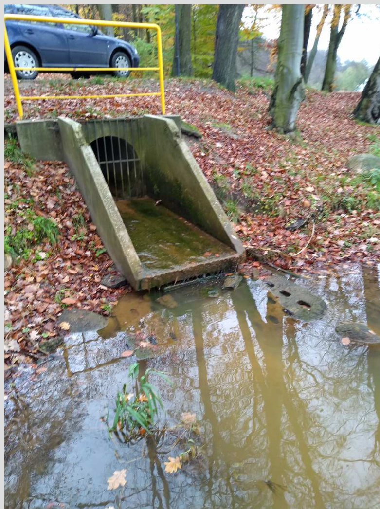
St. 16. Ujście kolektora nr 8 do Jeziora Klasztornego Małego
